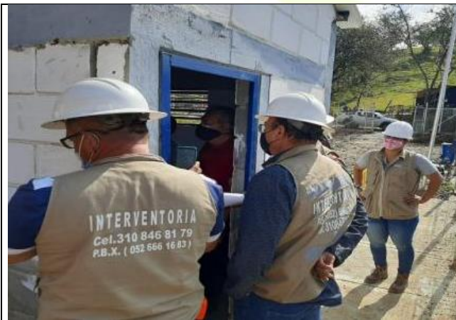
Revisión Del Sistema De Funcionamiento De Los Equipos Eléctricos
